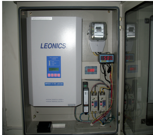
รูปที่ 4. เครื่องแปลงกระแสไฟฟ้า LEONICS
