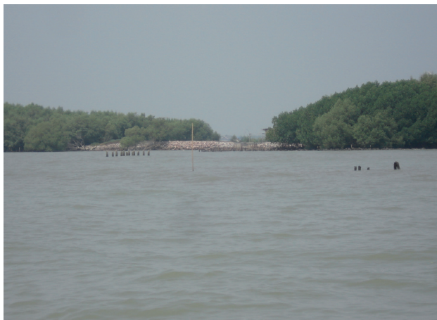
รูปที่ 8 การทรุดตัวของเขื่อนที่สร้างขึ้น
