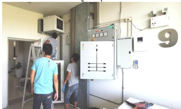
ภาพที่ 3.5 ลักษณะการติดตั้งอุปกรณ์กระจายสัญญาณ Wi-Fi
