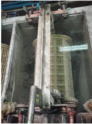
รูปที่ 24 บ่อที่ 18 ล้างด้วยน้ำ DI (อุณหภูมิสูง)
