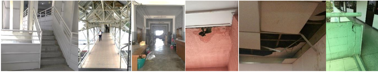
ภาพ 5 ตัวอย่างการต่อเติมอาคาร การเปลี่ยนแปลงลักษณะการใช้งานอาคาร และการชำรุดของอาคาร
