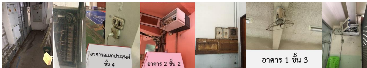
ภาพ 6 ตัวอย่างระบบไฟฟ้าภายในโรงเรียน
