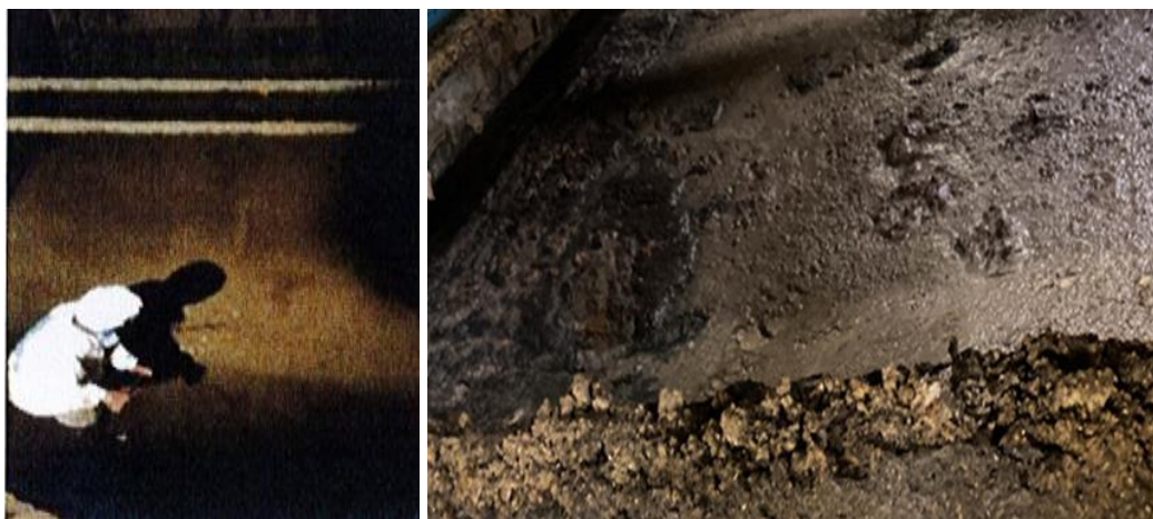
ภาพ 4 ปริมาณไขมันสะสมภายในบ่อบำบัดน้ำเสีย
