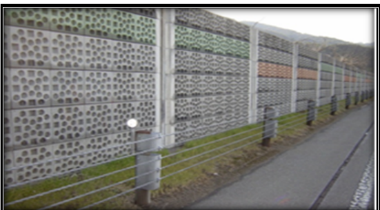
รูปที่ 6 คอนกรีตพูนใช้ลดเสียงดังจากการจราจร
