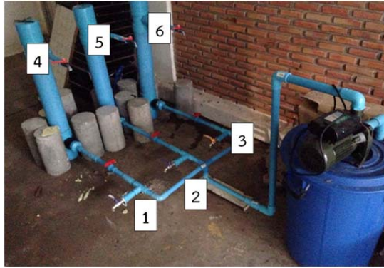
รูปที่ 5 ถังกรองไร้อากาศ
